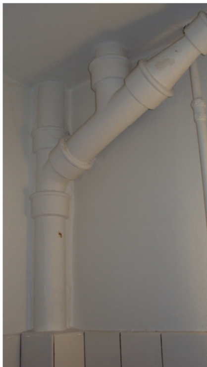
10. Rustgennemslag på faldstamme, Strandparken 2, 1. th.
