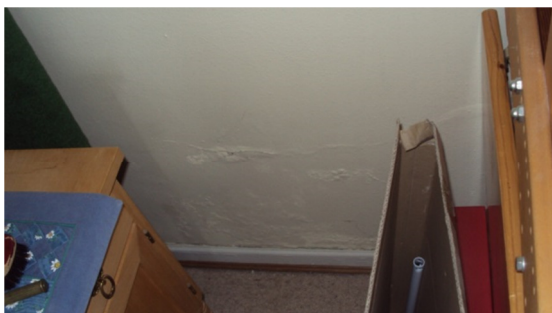
9. Fugt på indervæg i soveværelse, Strandparken 3, 2. tv.
