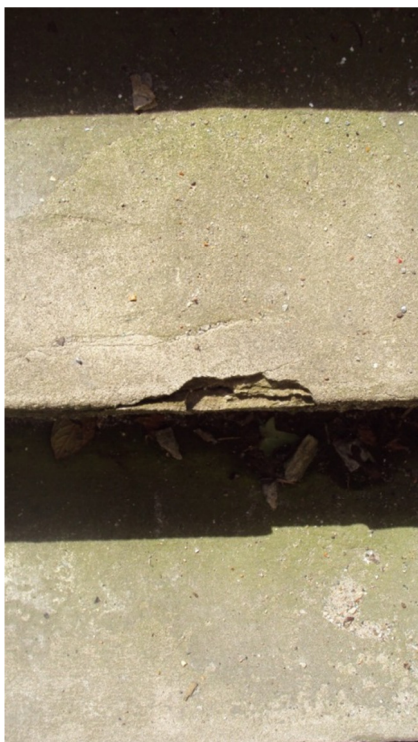
7. Kældertrappe ved opgang 1 har pudsskader.
