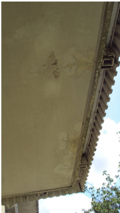
5. Områder på altanbundplader med begyndende betonskader.
