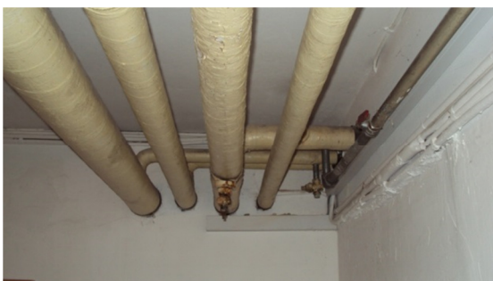
14. Varmerør og brugsvandsrør i kælderetage.
