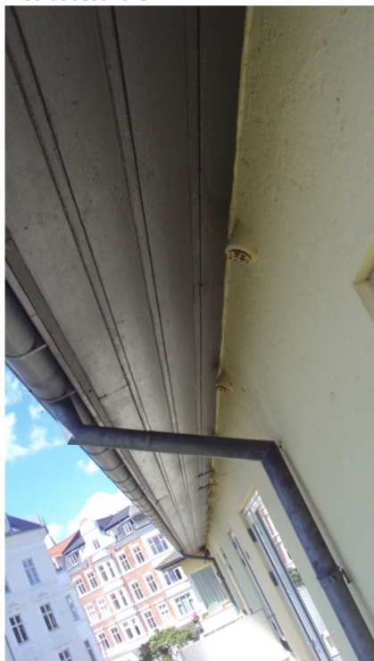
3. Tagrummet ventileres via imurede teglrør med trådnet.
