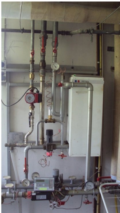
13. Varmeinstallation i kælder
