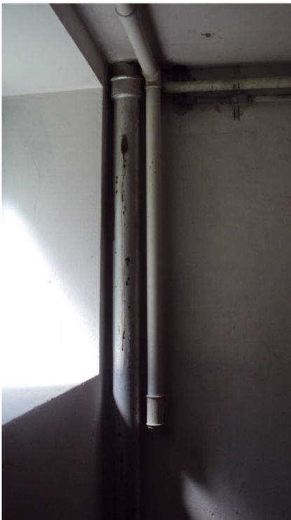
12. Faldstamme i kælder med korrosionsskader.
