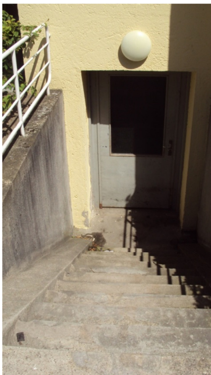
6. Kældertrappe ved opgang 1 har pudsskader.
