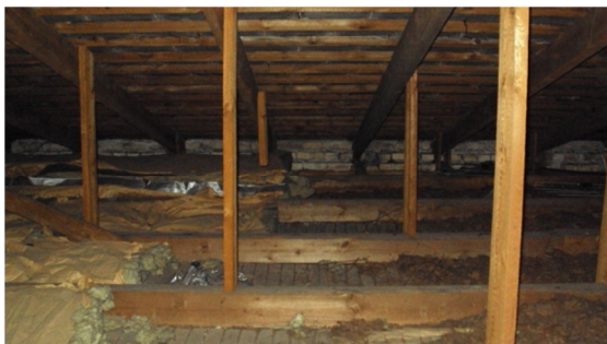
1. Tagrum med ringe/ingen isolering.
