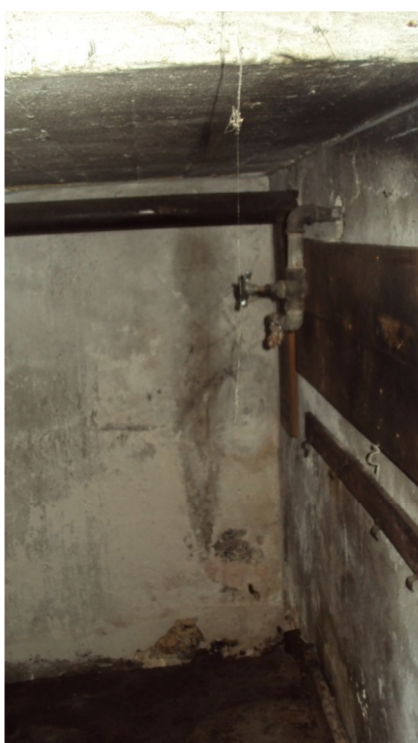
8. Utæt vandhane i el-tavlerummet ved opgang 2 bør sløjfes.
