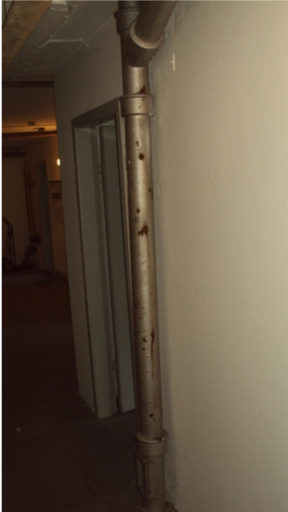
11. Faldstamme i kælder med korrosionsskader.
